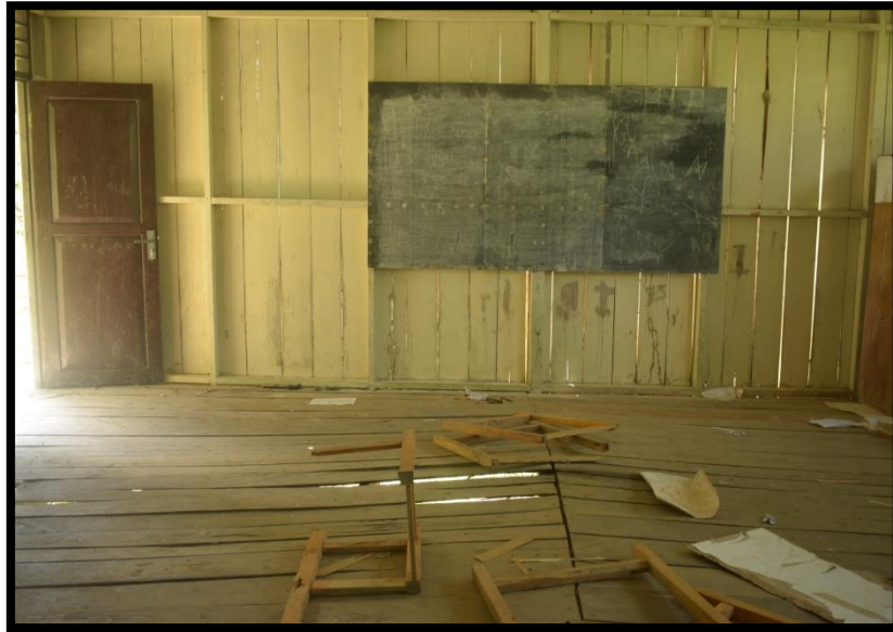
TAMPAKLAH KONDISI KERUSAKAN SDN LAWE BAGIAN DALAM RUANG KELAS
