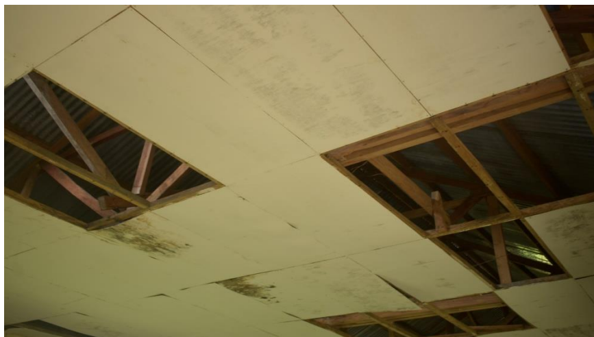
KONDISI KERUSAKAN BAGIAN PLAFON
