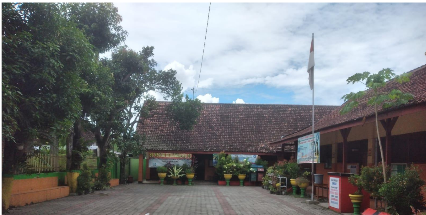
TAMPAK HALAMAN DAN KONDISI BANGUNAN YANG RUSAK
