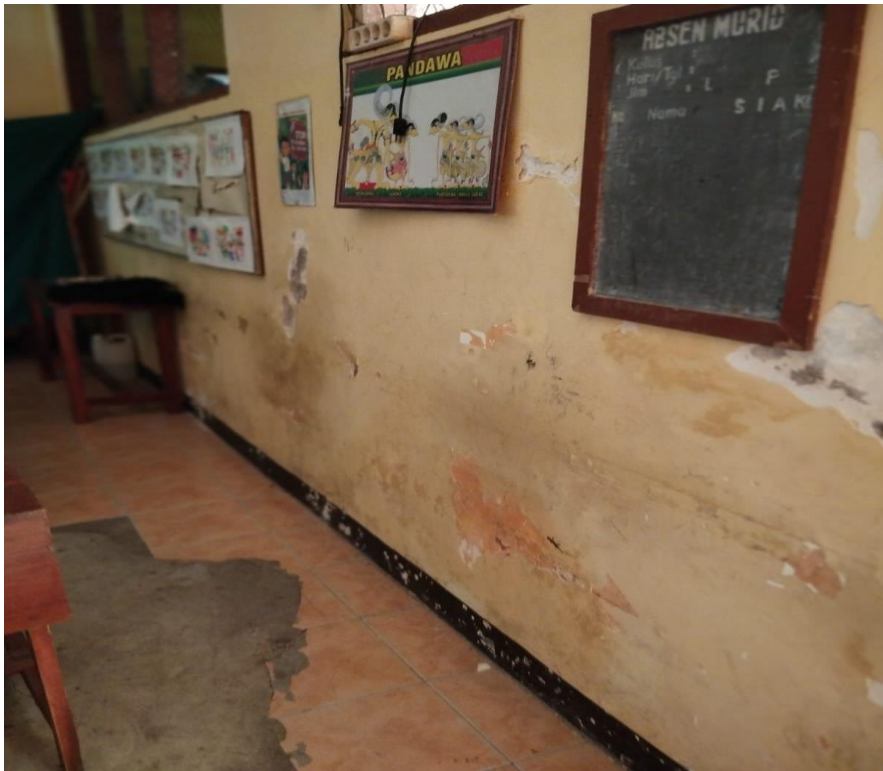
KEADAAN RUANG KELAS YANG RUSAK
